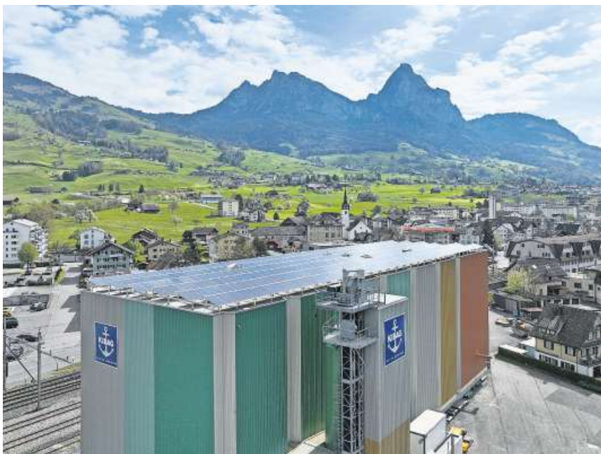
Die Fotovoltaikanlage auf dem Dach des Schotterwerks der Kibag in Seewen gehört zu den grössten PV-Anlagen im Kanton Schwyz. Bild: PD
